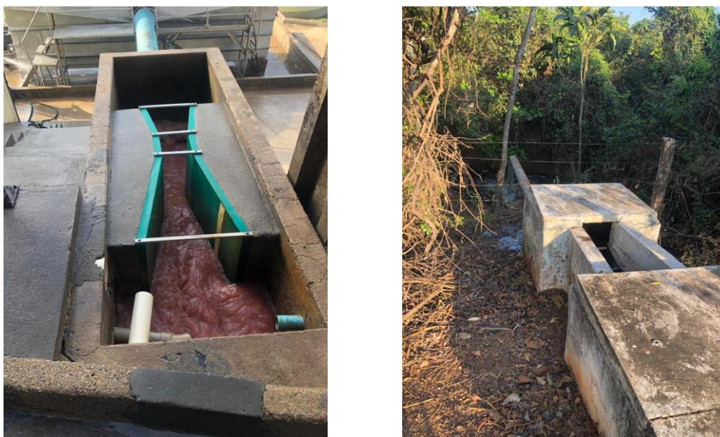
Figura 7. Pontos de coleta do efluente bruto (esq.) e tratado (dir.) – calhas parshall inicial e final
